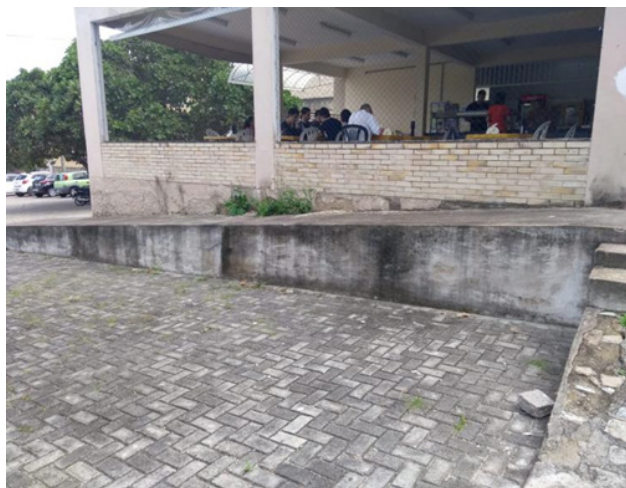
Figura -1: lateral da lanchonete, destaca-se a ausência de sinalização tátil e de guarda corpos nas estruturas de acesso a referida área.
