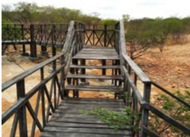
FIGURA 11: DETALHE DE INVASÃO DA VEGETAÇÃO CAUSADA PELA AUSÊNCIA DE MANUTENÇÃO NA ESTRUTURA DO SÍTIO.
