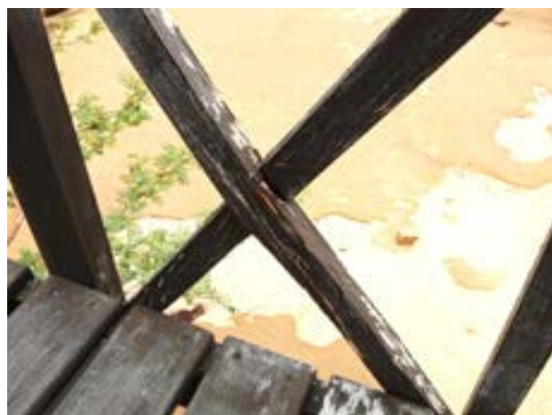
FIGURA 8: DETALHE DE ESTRUTURA DE MADEIRA FRAGILIZADA PELO DESGASTE NATURAL.
