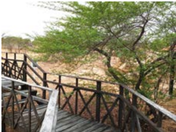
FIGURA 9: VISÃO DE INVASÃO DA VEGETAÇÃO CAUSADA PELA AUSÊNCIA DE MANUTENÇÃO NA ESTRUTURA DO SÍTIO.
