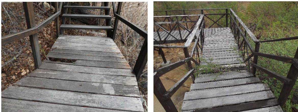
FIGURAS 26 A 27: AUSÊNCIA DE CONSERVAÇÃO - IMAGENS DE PASSARELAS COM TÁBUAS QUEBRADAS (SÍTIO ARQUEOLÓGICO MIRADOR DE PARELHAS-RN) E VEGETAÇÃO INVADINDO AS PASSARELAS (SÍTIO ARQUEOLÓGICO ABERNAL -- SERRA NEGRA DO NORTE-RN).
